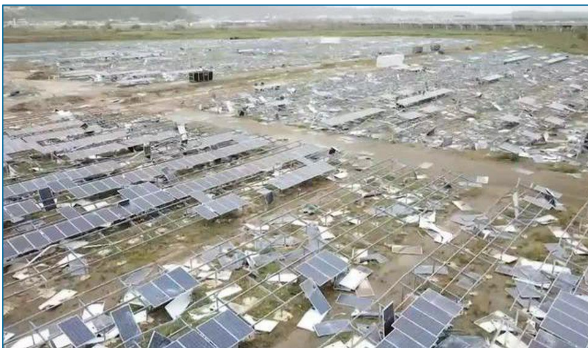
Рис.75. Разрушение солнечной фермы в Пуэрто-Рико
